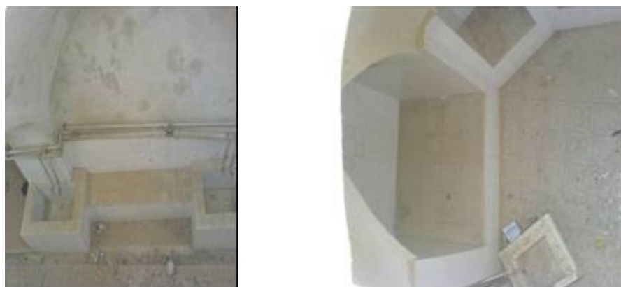
تصویر شماره (۴): حمام روستا قبل از تخریب
